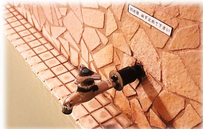
修学旅行先の温泉浴場の蛇口の腐食
